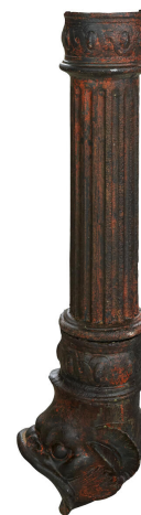
Descente de gouttière en fonte terminée par un dauphin. Descente d'origine déposée aujourd'hui dans la sacristie. Phot. Delphine Volto-Jourdan IVR32_20246200046NUCA
