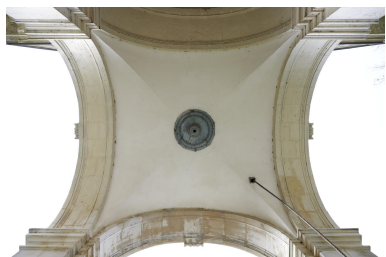
Vue des voûtains de la fausse voûte en plâtre de la loggia (avec au centre la clef annulaire amovible). Phot. Delphine Volto-Jourdan IVR32_20246200009NUCA
