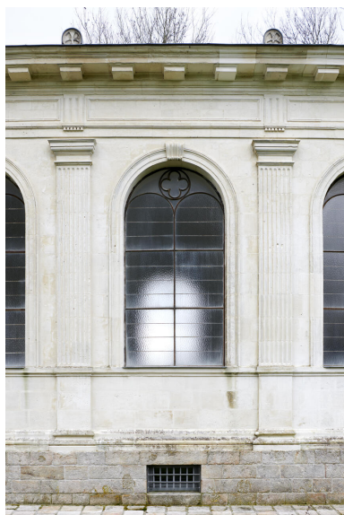
Vue de détail de la travée centrale du mur-gouttereau nord-ouest. Phot. Delphine Volto-Jourdan IVR32_20246200015NUCA
