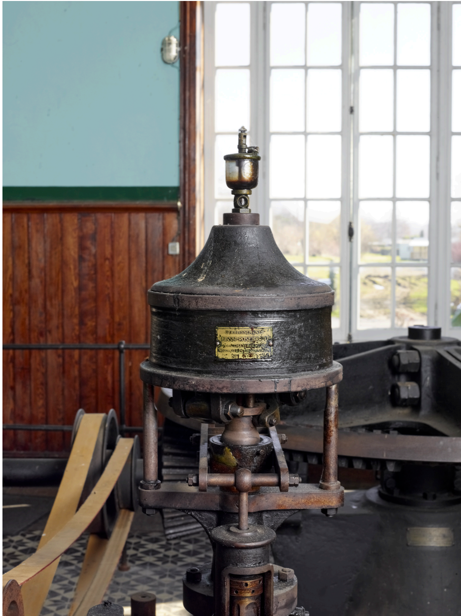
Intérieur, régulateur de pression de la troisième turbine.
