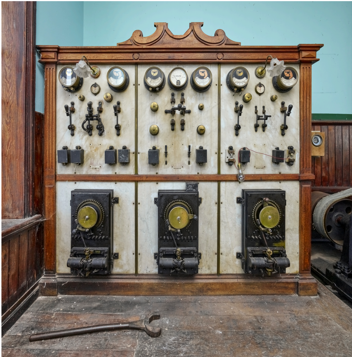
Intérieur, tableau de contrôle.
