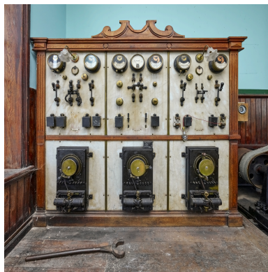
Intérieur, tableau de contrôle. Phot. Thierry Lefébure IVR32_20258000589NUCA
