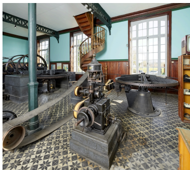
Intérieur, la troisième turbine de la centrale. Phot. Thierry Lefébure IVR32_20258000594NUCA
