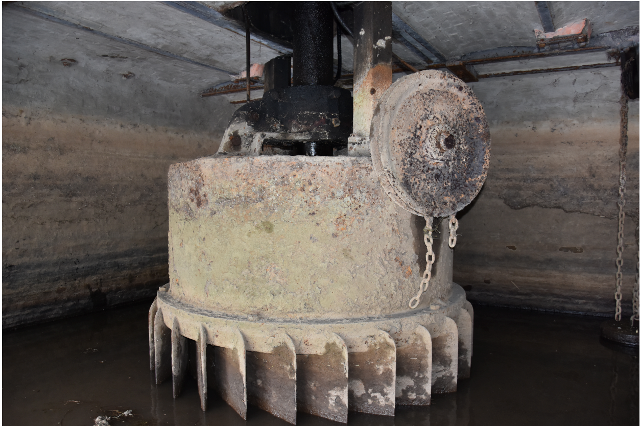
Une des turbines de l'usine.
