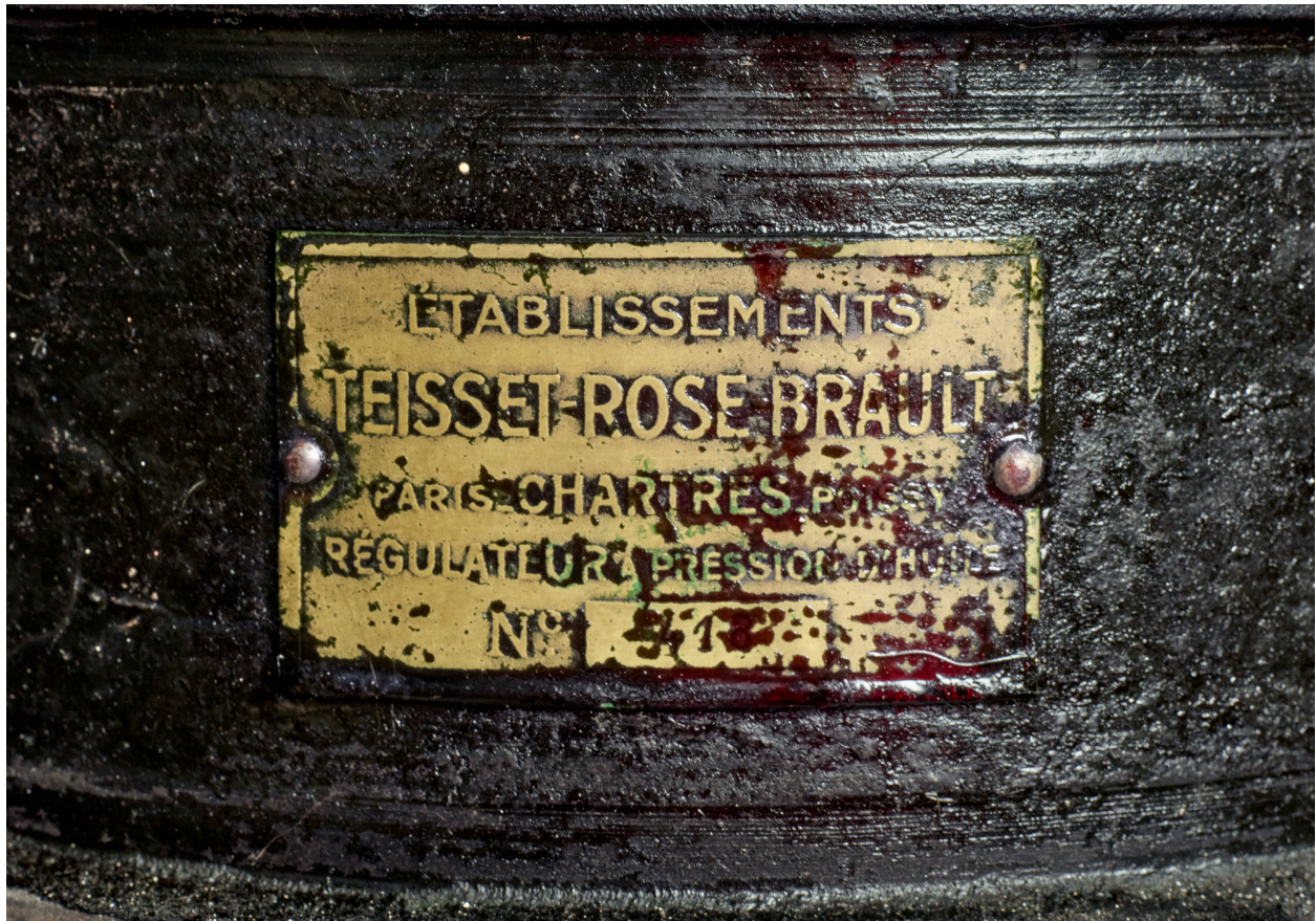
Intérieur, plaque du constructeur du régulateur de pression d'huile, troisième turbine.
