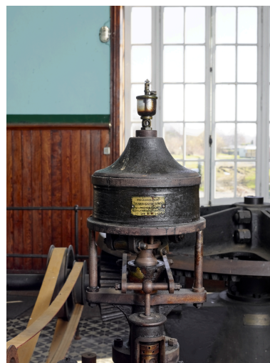
Intérieur, régulateur de pression de la troisième turbine. Phot. Thierry Lefébure IVR32_20258000597NUCA
