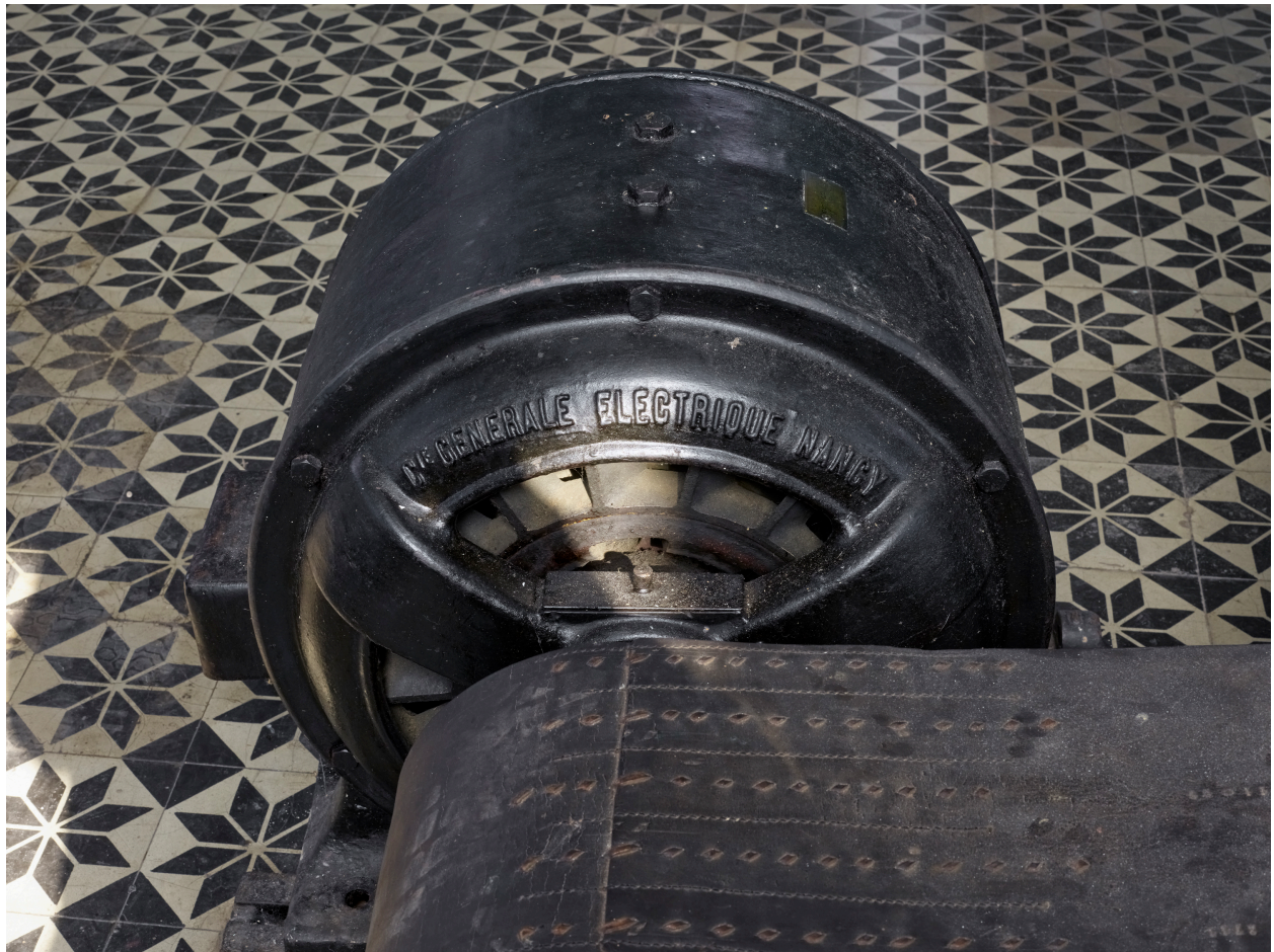
Intérieur, signature du constructeur sur la troisième turbine.
