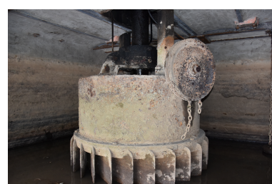
Une des turbines de l'usine. Phot. Jérémie Albert-Brunet IVR32_20258011201NUCA
