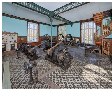
Intérieur, les deux premières turbines de la centrale. Phot. Thierry Lefébure IVR32_20258000583NUCA
