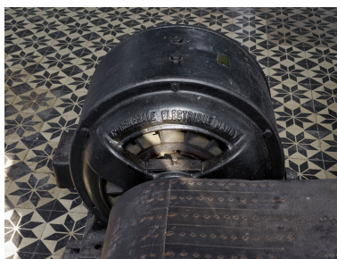
Intérieur, signature du constructeur sur la troisième turbine. Phot. Thierry Lefébure IVR32_20258000599NUCA
