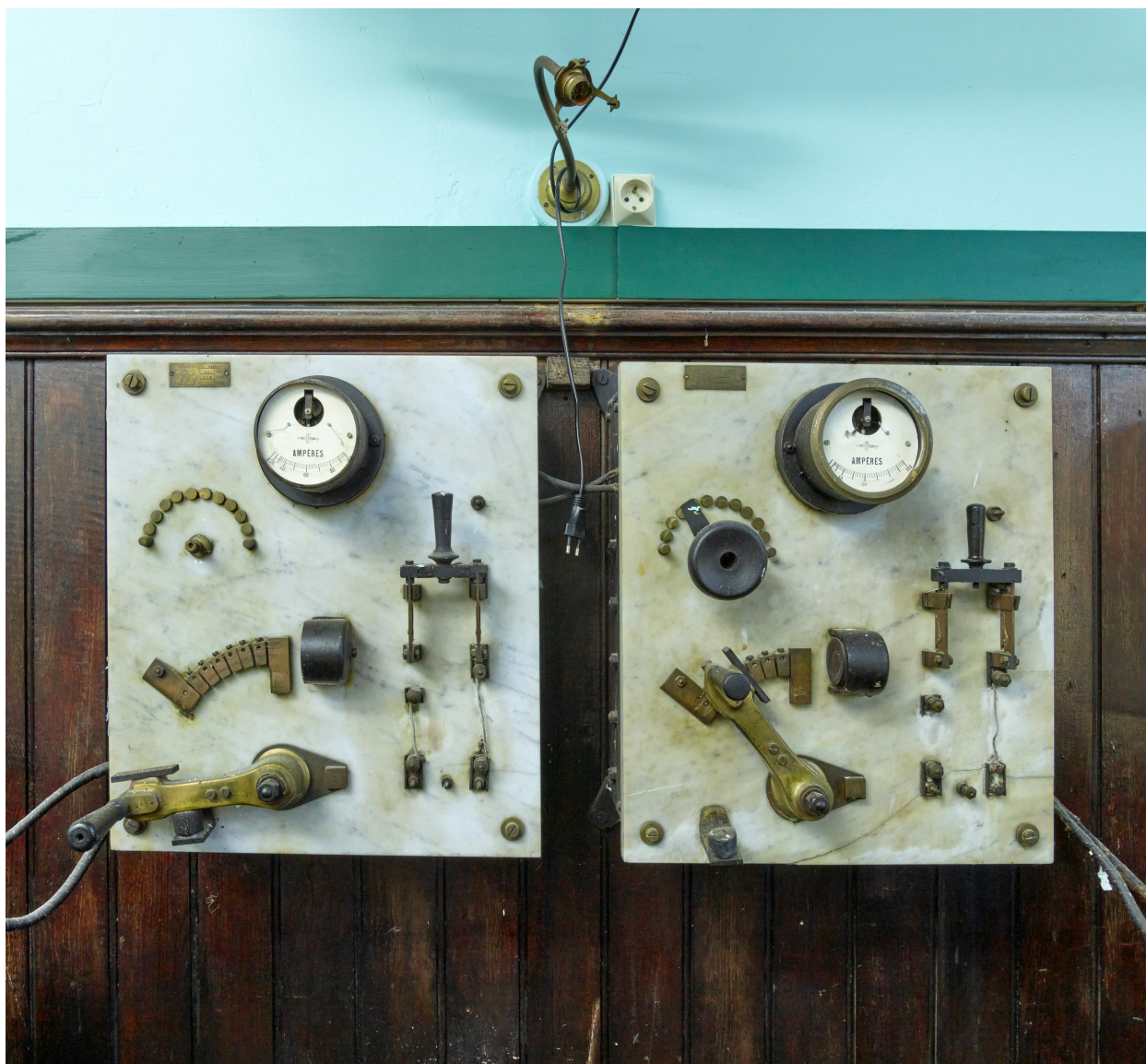
Intérieur, tableau de contrôle de la pompe à eau.
