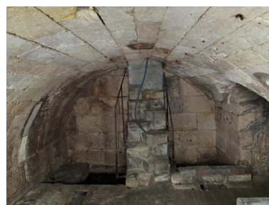
Ancienne hôtellerie de l'Enfer : cave aménagée en cellier réfrigéré sous l'ancienne cuisine.
