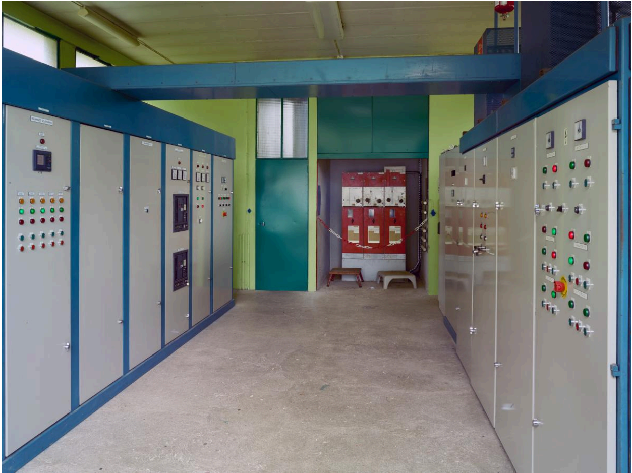
Intérieur du poste de commande. Tableaux électriques. Vue vers l'est.
