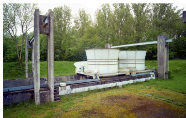
Turbines de ventilation et rails de maintenance. Vue depuis la plateforme du poste de commande. Phot. Pierre Thibaut IVR32_20216200794NUC4
