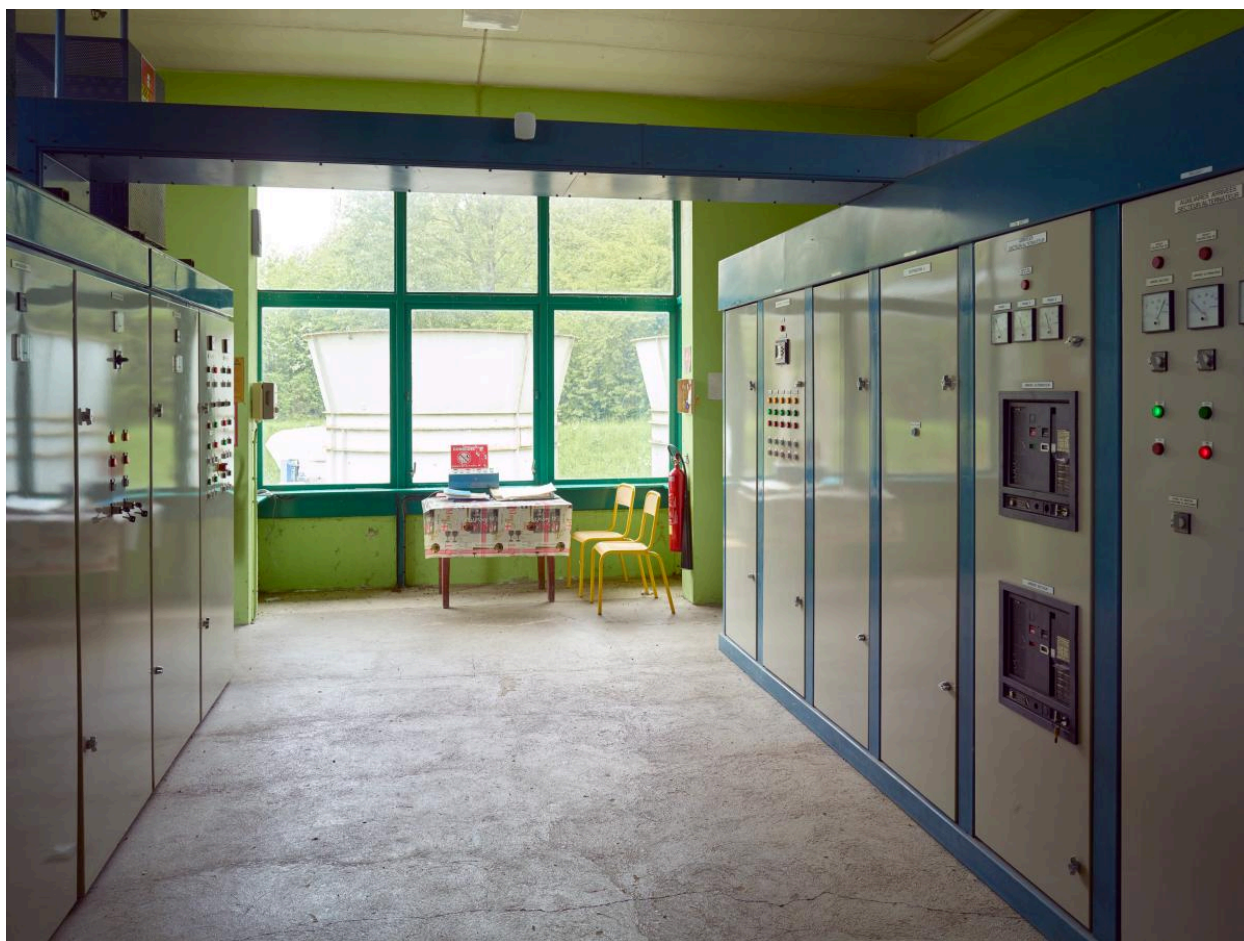
Intérieur du poste de commande et les tableaux électriques. Vue vers le bow-window.
