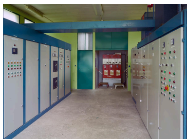
Intérieur du poste de commande. Tableaux électriques. Vue vers l'est. Phot. Pierre Thibaut IVR32_20216200757NUC4
