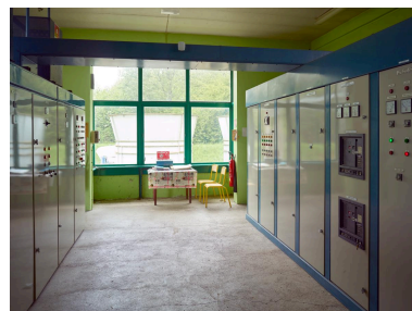
Intérieur du poste de commande et les tableaux électriques. Vue vers le bow-window. Phot. Pierre Thibaut IVR32_20216200758NUC4
