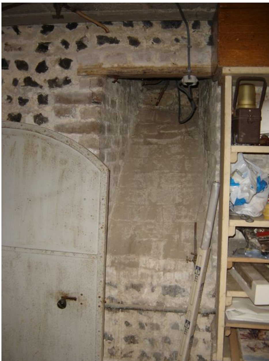
Système d'aération de la cave.
