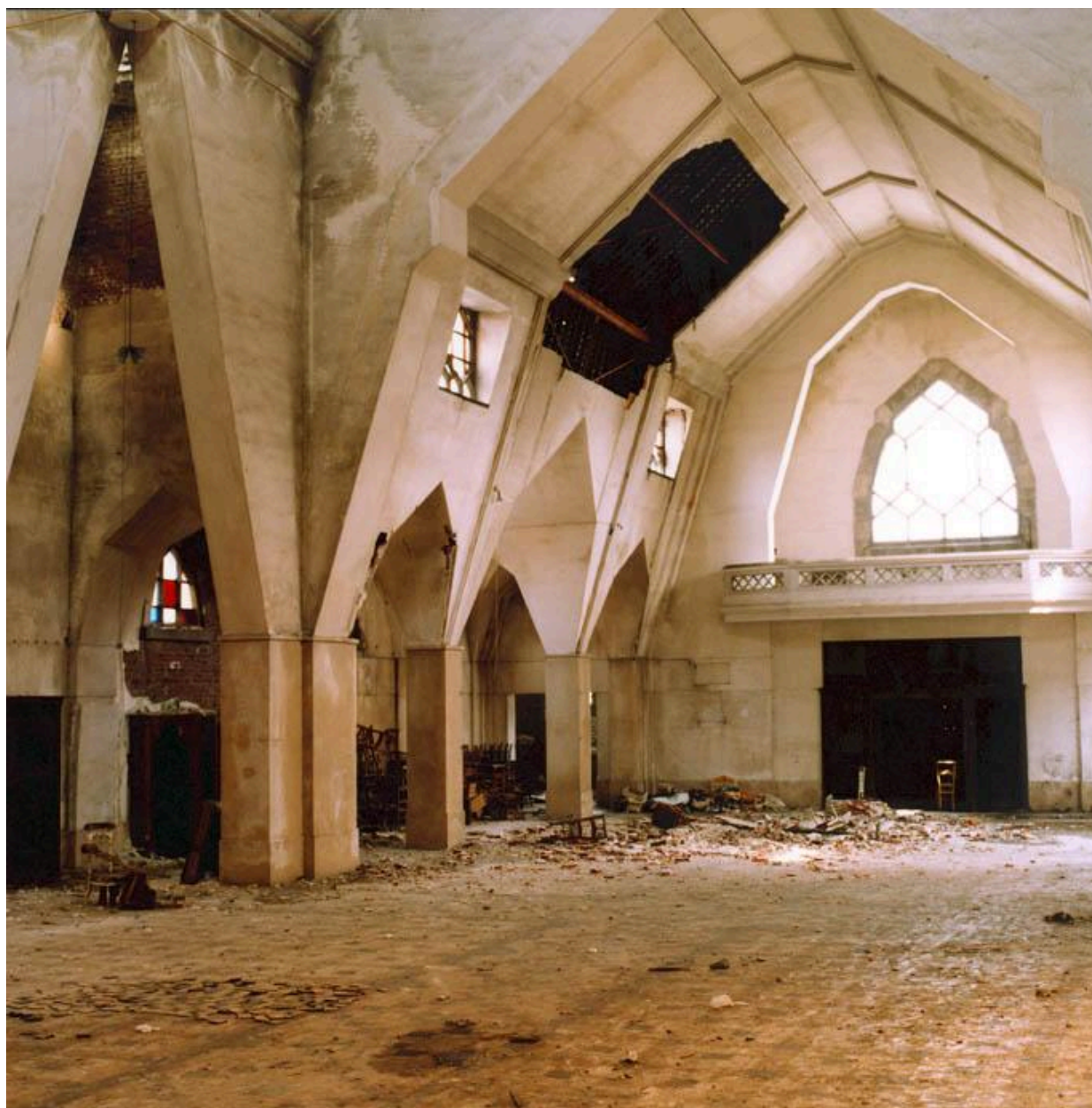
Vue générale intérieure, vers l'entrée, avant sa destruction. Photographie, photographe inconnu, circa 1985-1986 (AC Aulnoye-Aymeries).
