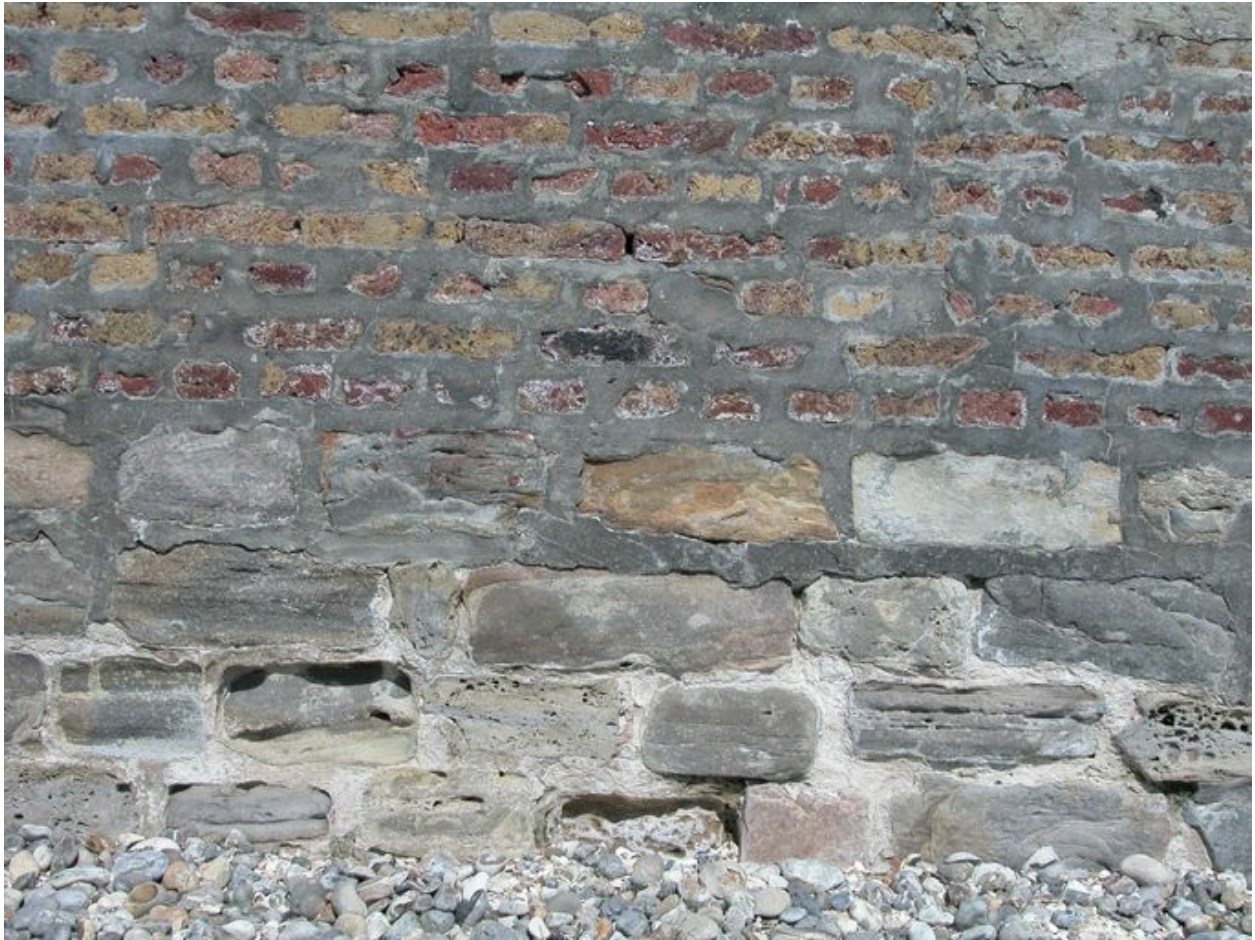
Vue de détail de la maçonnerie des rampes d'accès à la plage.
