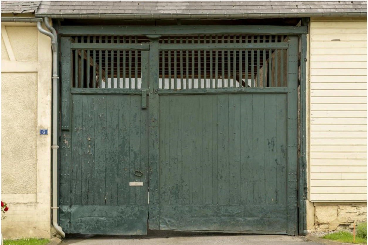
Porte charretière, vue de face depuis la rue, 4e quart 19e siècle.
