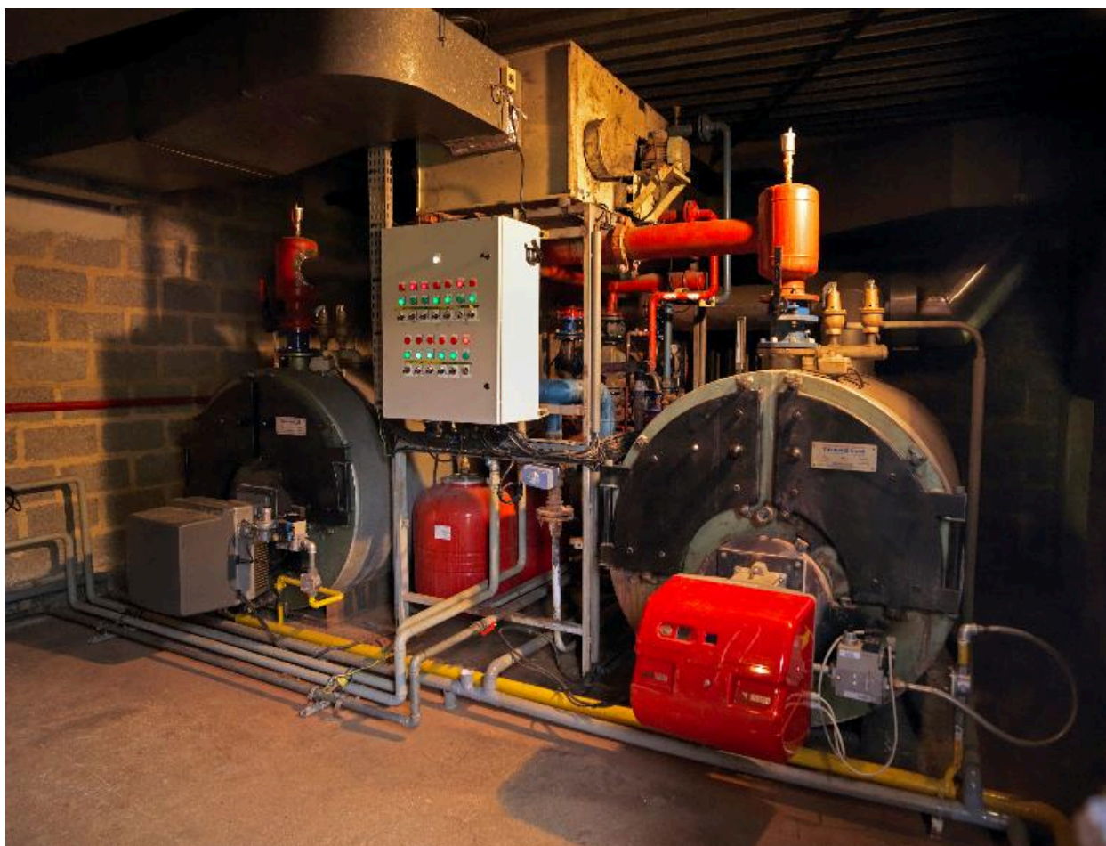
Local technique : chaudières.
