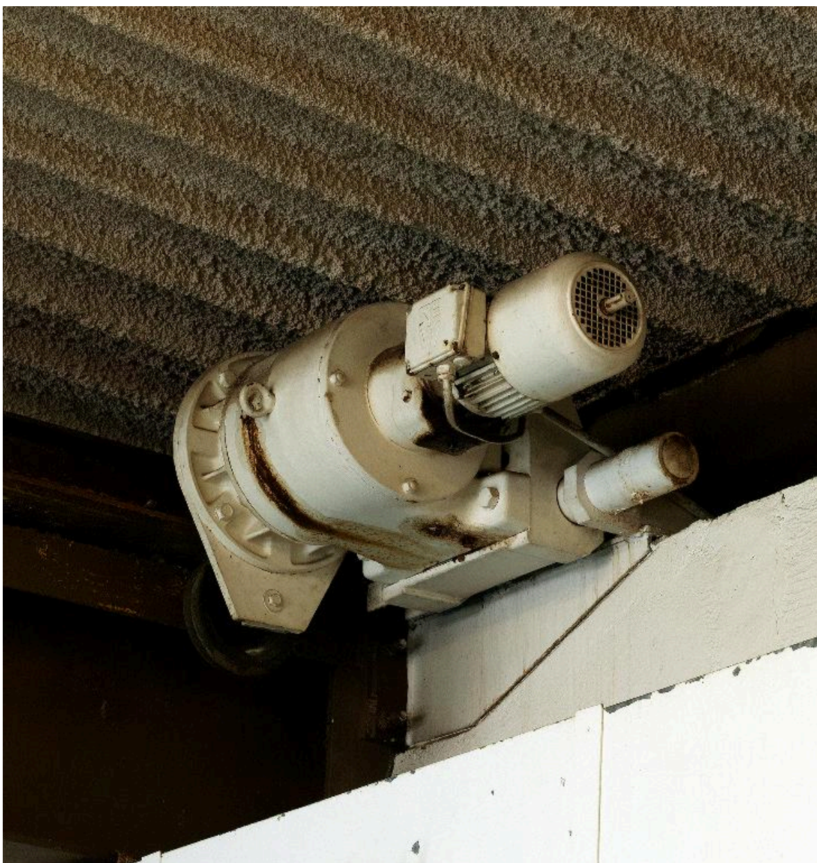
Détail d'un des moteurs actionnant le glissement de la toiture mobile.
