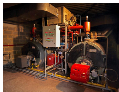
Local technique : chaudières. Phot. Marie-Laure Monnehay-Vulliet IVR32_20178000445NUC2A
