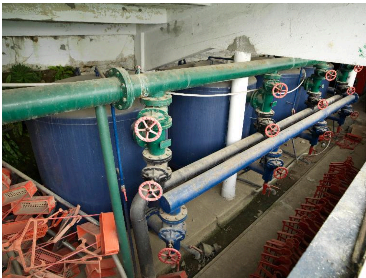
Cuves de filtration de la piscine découverte (sous les gradins).
