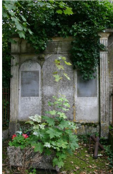
Trois stèles cintrées ont été plaquées contre la stèle funéraire d'origine, rythmée par des pilastres cannelés. Phot. Caroline Vincent IVR22_20068001393NUCA
