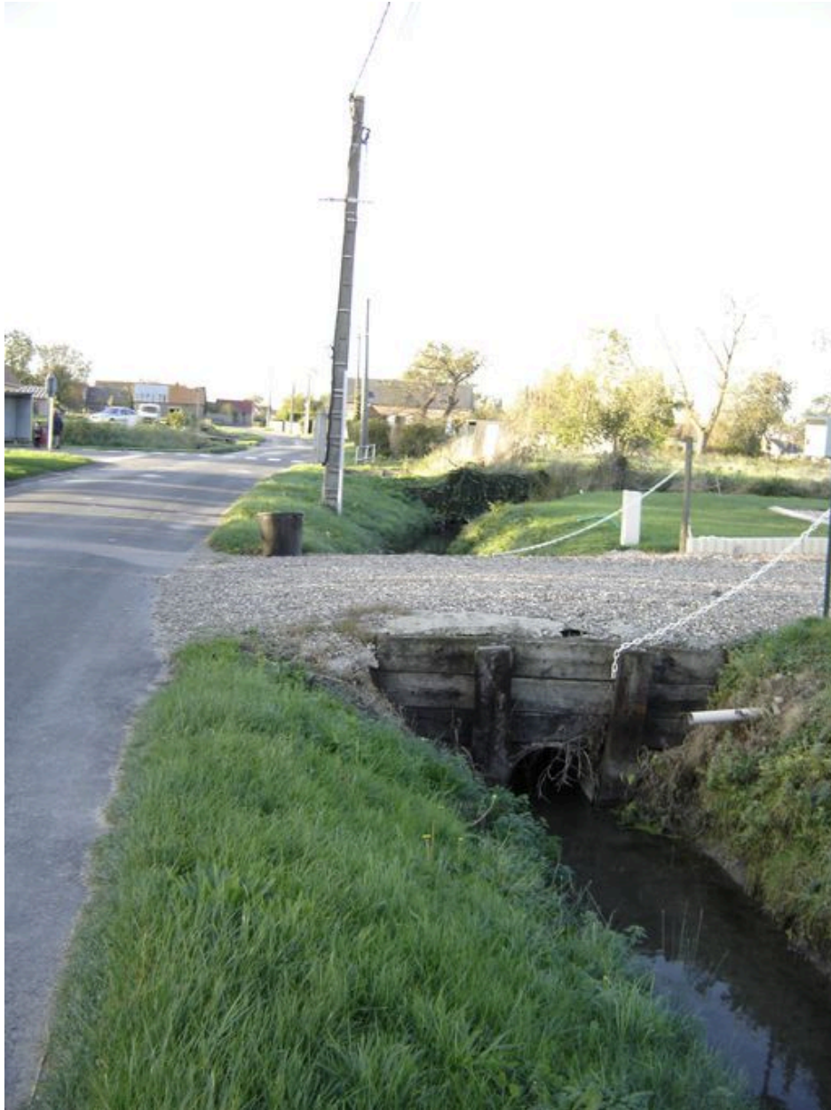
Système de canaux drainant les eaux le long des voies de circulation.
