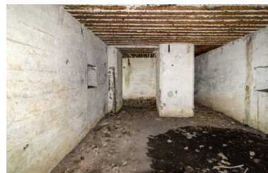
Vue intérieure (au grand angle). Au fond à gauche, la sortie ouest, à droite l'accès à la coursière de tir. Phot. Jean-Marc Ramette IVR32_20165901124NUCA
