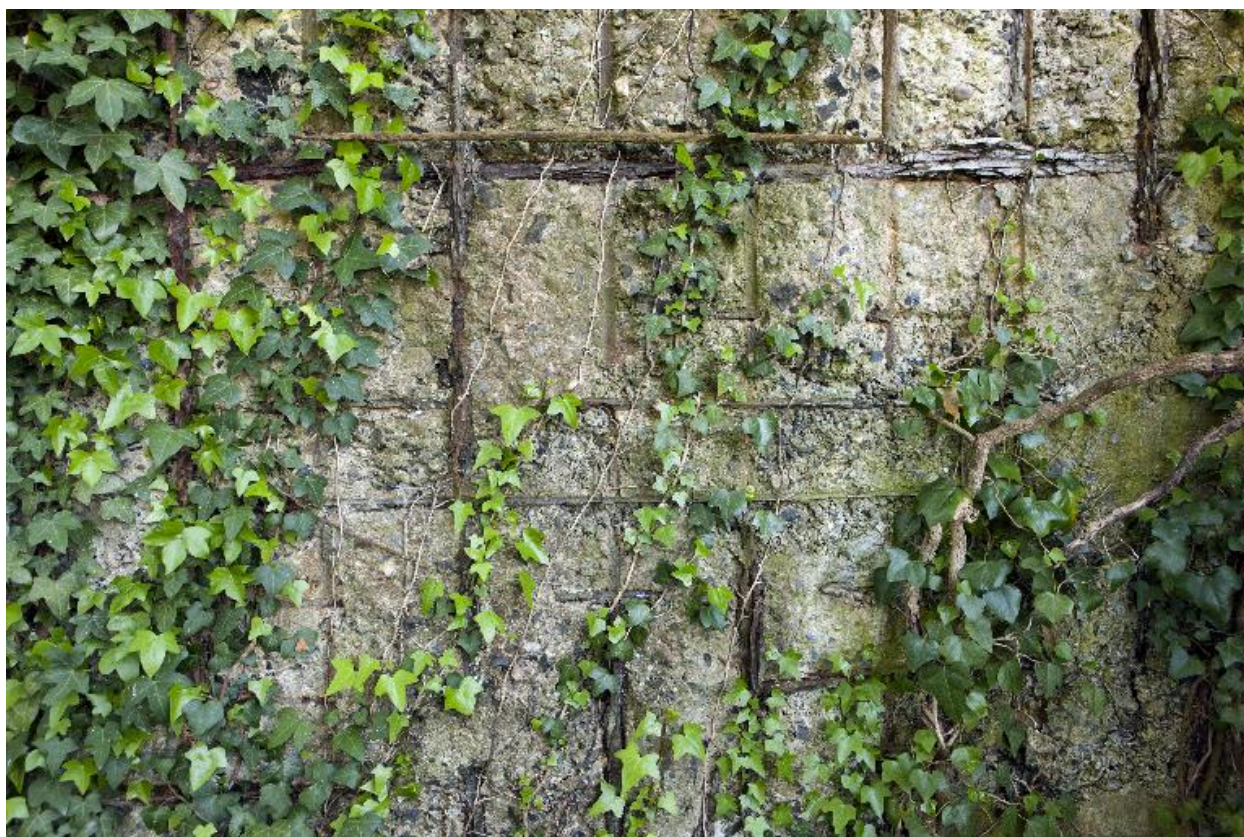
Elévation est, détail des fers apparents
