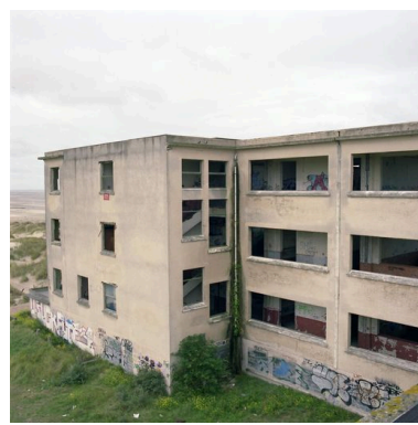
Détail de la moitié sud du bâtiment d'hospitalisation, élévation postérieure, vue prise de trois-quarts droit. Phot. Pierre Thibaut IVR31_20096200041XE
