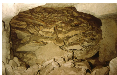
Vue d'une galerie obstruée. Phot. Thierry Hardier IVR22_20050200513NUCA
