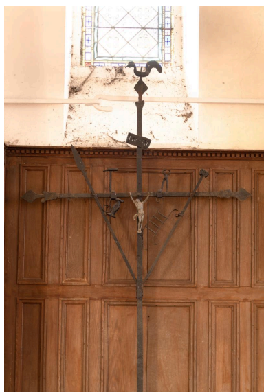
Croix de la passion, vue de la partie supérieure. Phot. Marc Kérignard IVR32_20226001078NUCA
