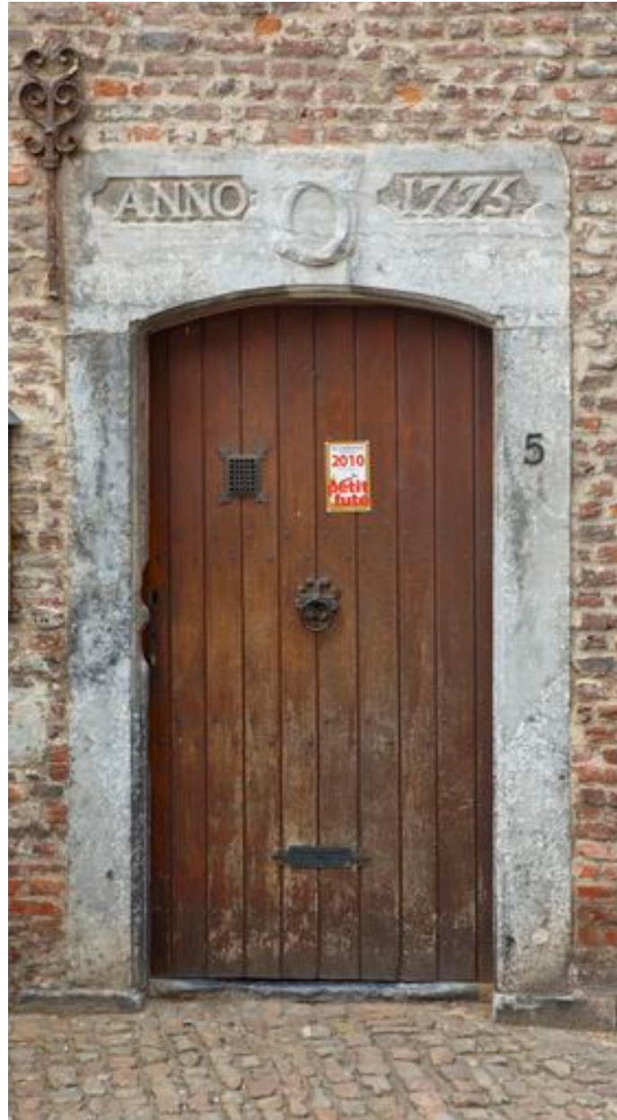
Façade-pignon, détail : porte dont le linteau affiche la date de construction et le monogramme du duc de Croÿ.
