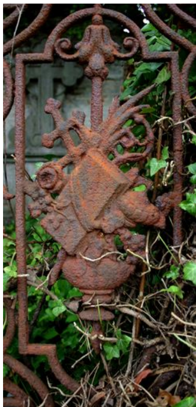
Détail du décor du vantail droit de la grille de clôture. Phot. Caroline Vincent
