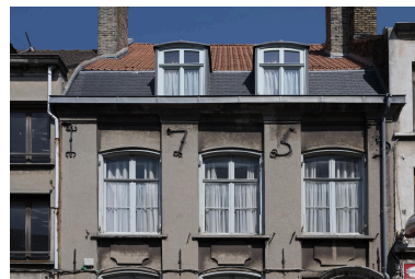
Vue de la date 1755 sur les fers d'ancrage. Phot. Pierre Thibaut IVR32_20255900656NUCA
