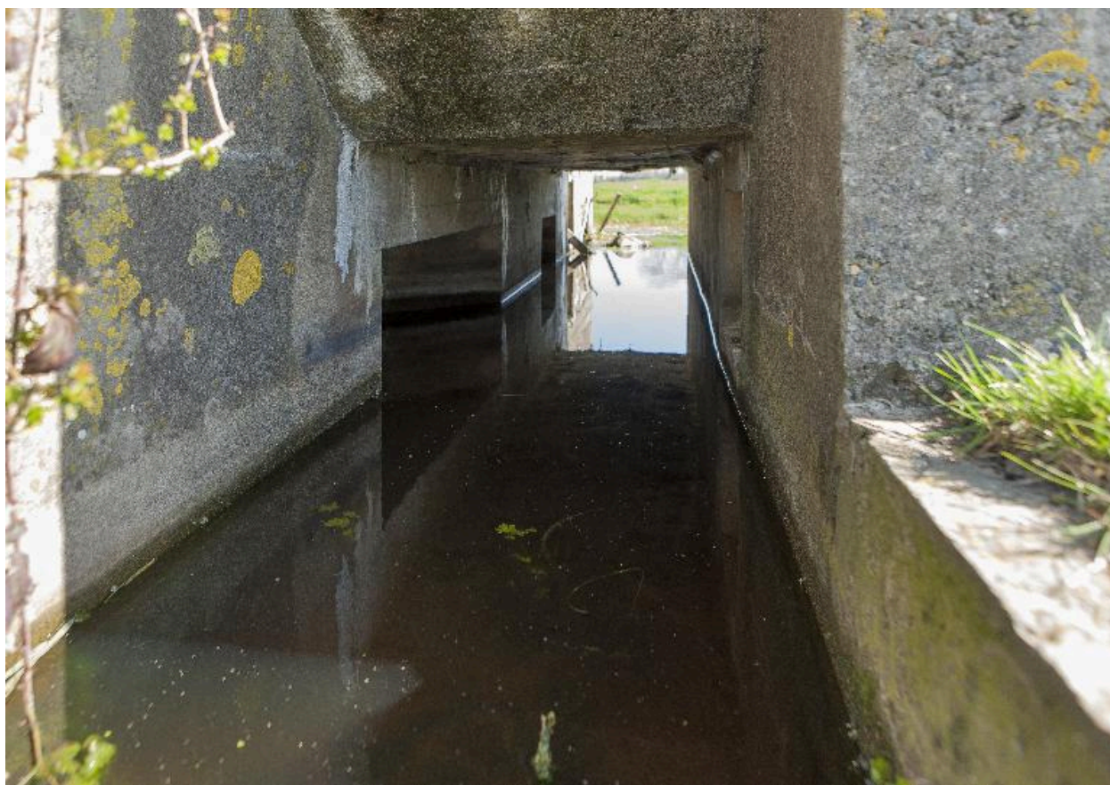
Entrée inondée sous le porche pare-souffle
