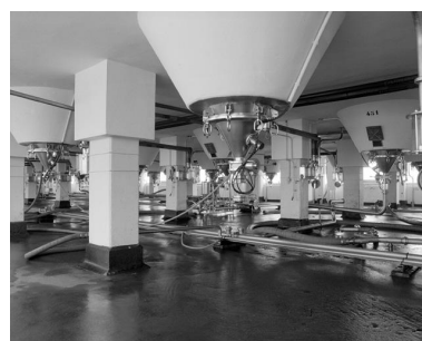
Salle de fermentation, niveau inférieur : cuves cylindroconiques. Phot. Thierry Petitberghien IVR31_19915900561X
