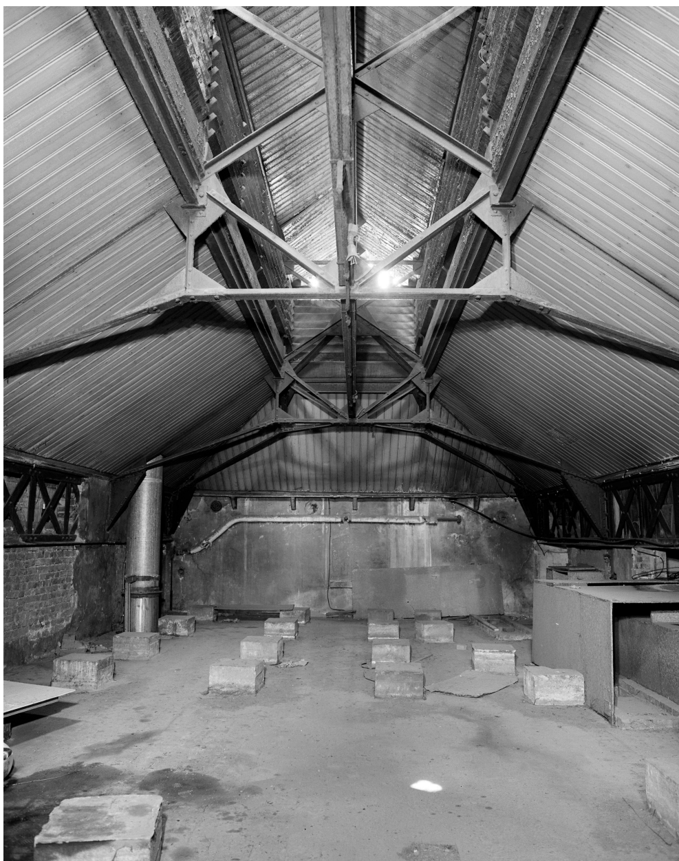
Atelier de fabrication (refroidissement de la bière), vue intérieure.
