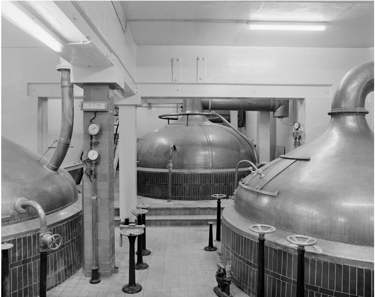
Salle de brassage, vue générale.
