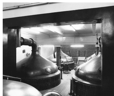
Salle de brassage, vue générale. Phot. Thierry Petitberghien IVR31_19915900557X
