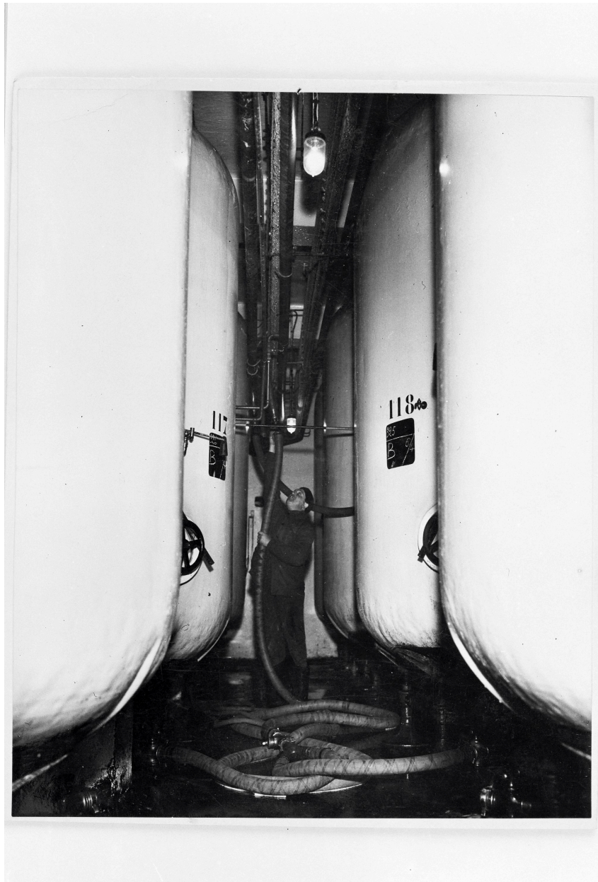
Salle de garde, tanks verticaux (AP Coutances).
