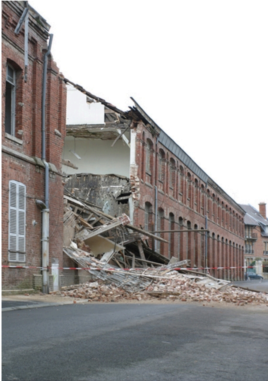
Effondrement d'une partie des ateliers de tissage, rue Richard-Lenoir, en janvier 2005.
