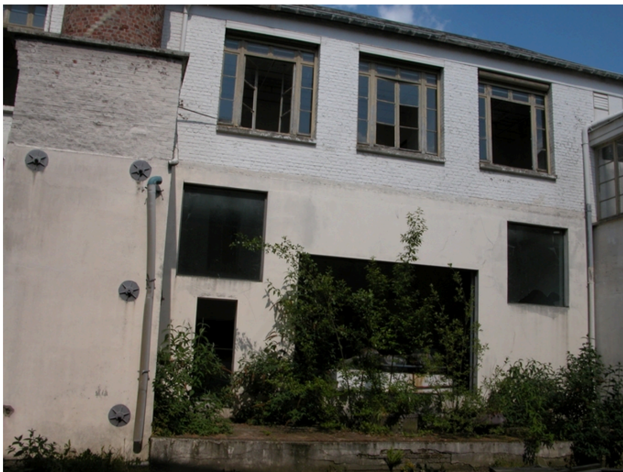
Salle des machines (rez-de-chaussée), cabinet de fabrication (étage) et piédestal de la cheminée d'usine.
