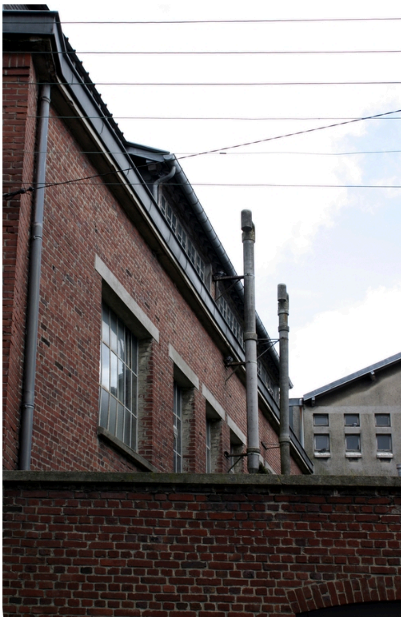
L'extension des anciens magasins rue de Mulhouse et Cité de Mulhouse construite dans l'entre-deux-guerres : façade postérieure, rue de Colmar.
