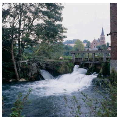
Le vannage de décharge.
