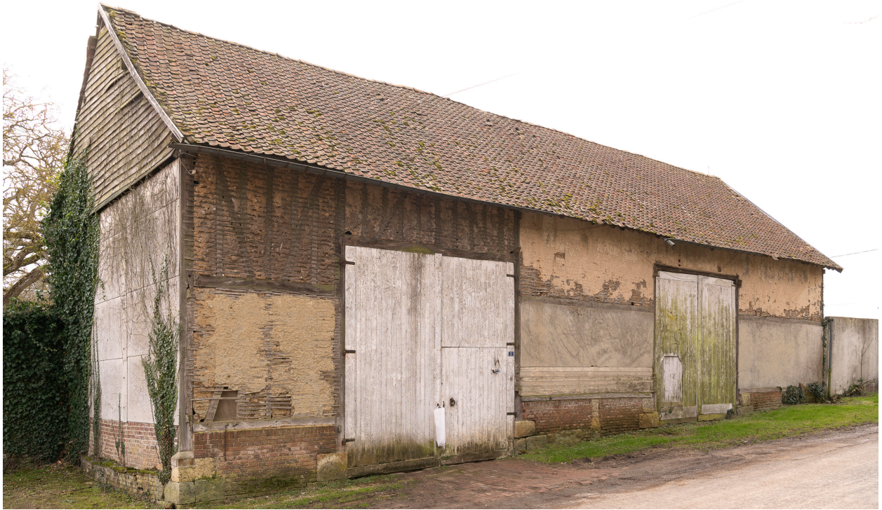
Grange et entrée charretière de la ferme au n°2 de la rue de Warmaise, vue depuis le nord.
