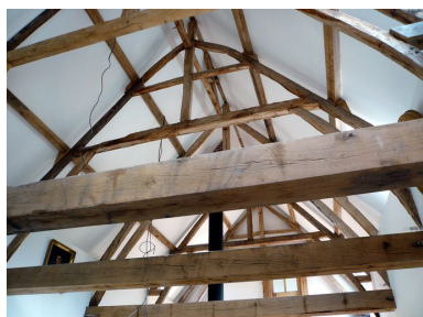
Vue d'une partie de la charpente du logis. Phot. Inès Guérin IVR22_20078005894NUCA
