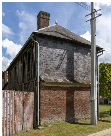
Pignon avec essentage en ardoise, n°37 Grande Rue, vue depuis l'ouest. Phot. Marc Kérignard IVR32_20216000428NUCA
