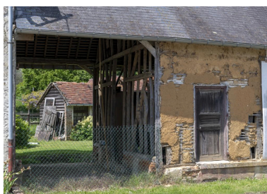
Détail d'une entrée charretière en pans de bois et torchis, n°17 Grande Rue, vue depuis le sud-est. Phot. Marc Kérignard IVR32_20216000635NUCA
