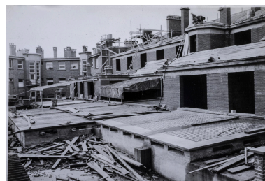
Dunkerque. Succursale de la Banque de France. Chantier de construction, côté cour, photographie noir et blanc, [ca 1953] (AC Dunkerque, fonds Morel (non coté)). Repro. Pierre Thibaut IVR32_20255901371NUCA
