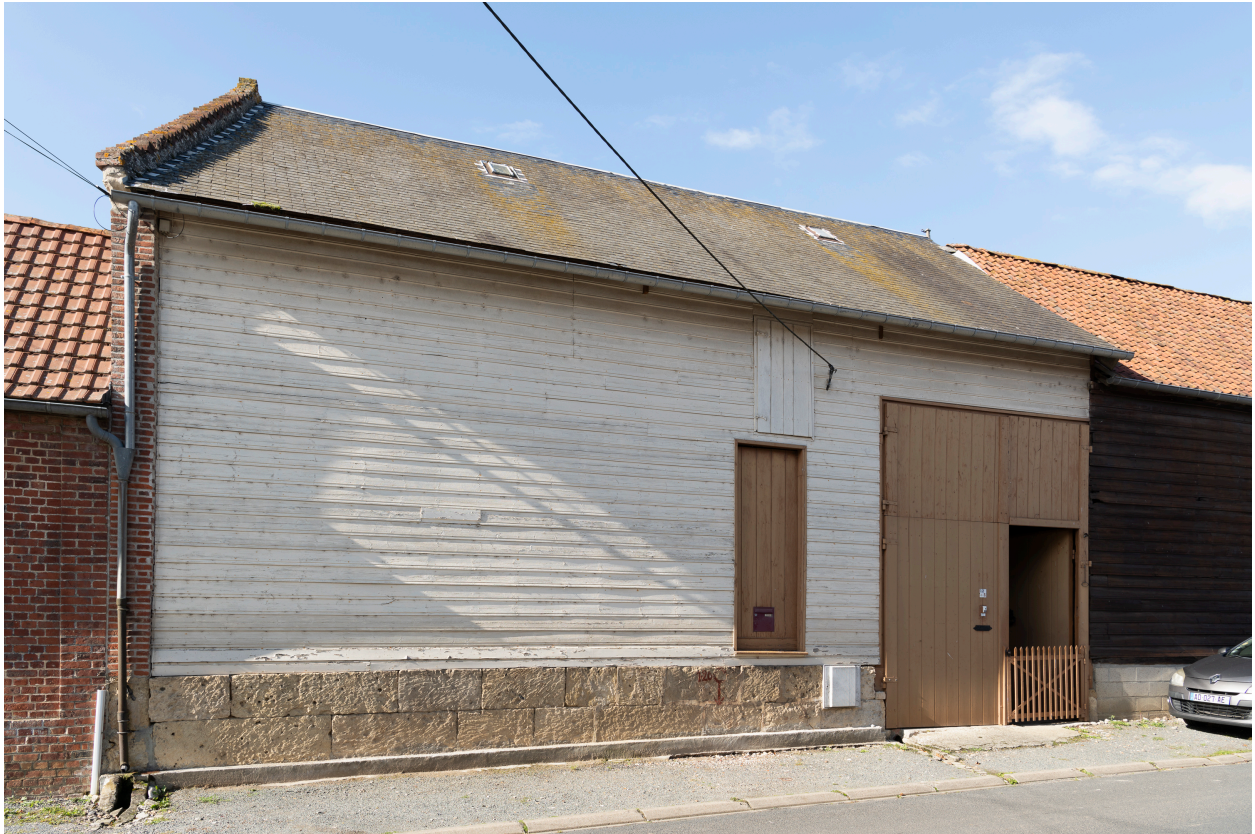
Grange essentée de planches avec porte à engranger, n°12 de la rue Fernand-Moreau, vue depuis le sud.
