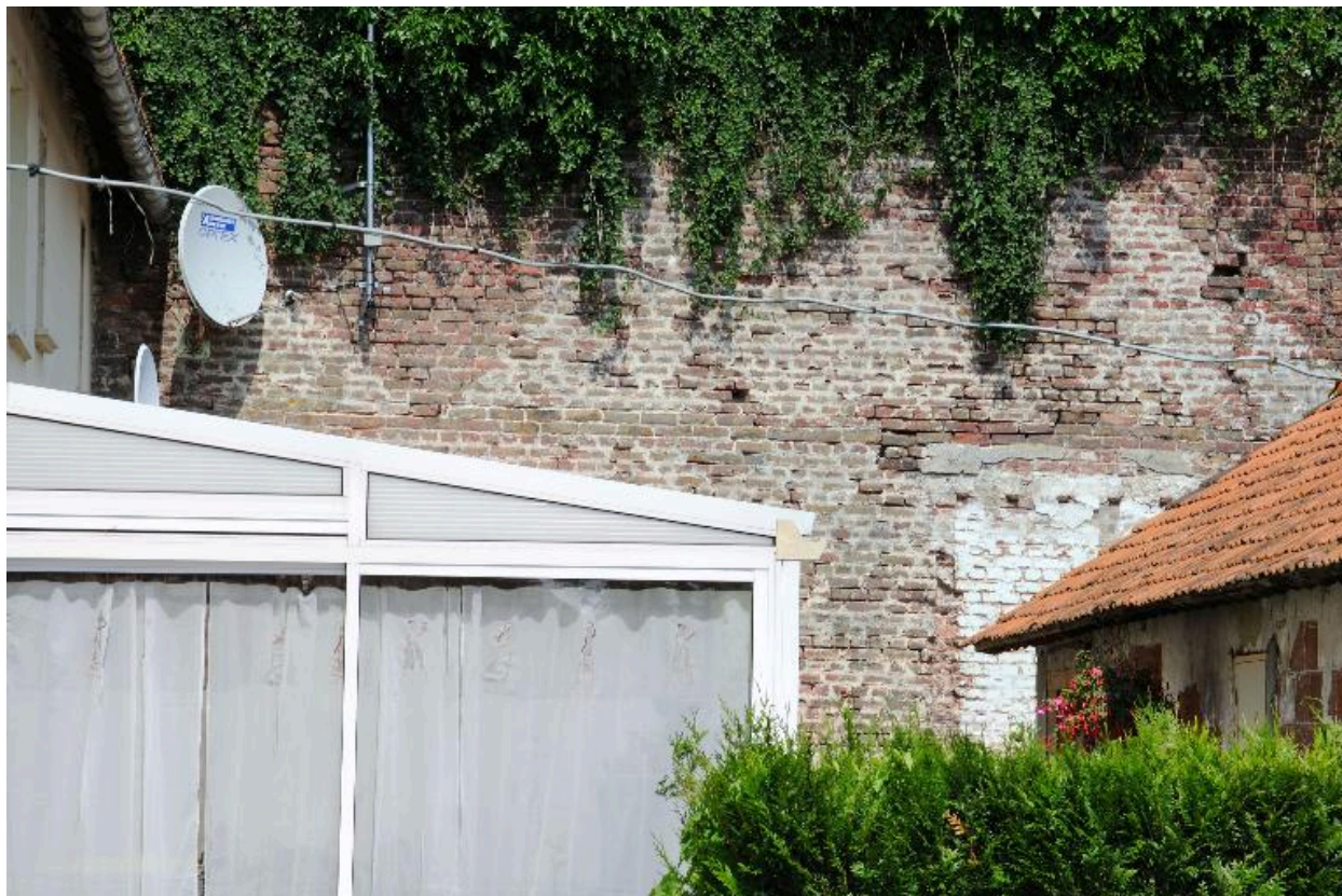
Traces d'un ancienne toiture en shed sur le mur en brique en fond de parcelle.
