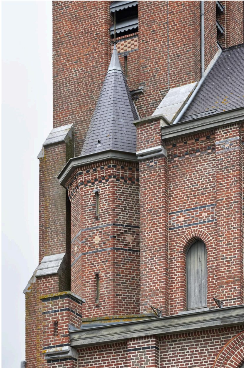
Détails du 1er niveau dont tourelle d'escalier et porte d'accès au toit.
