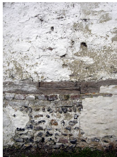
Détail du solin en silex et briques ainsi que de la sablière basse à assemblage à mi-bois de la grange. Phot. Inès Guérin IVR22_20058005080NUCA
