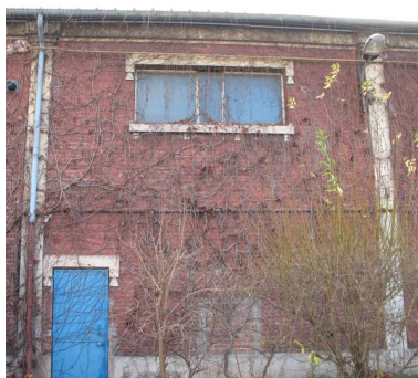
Détail de l'une des travées du mur nord de la salle des fêtes. Phot. Clarisse Lorieux IVR22_20066005118NUCA
