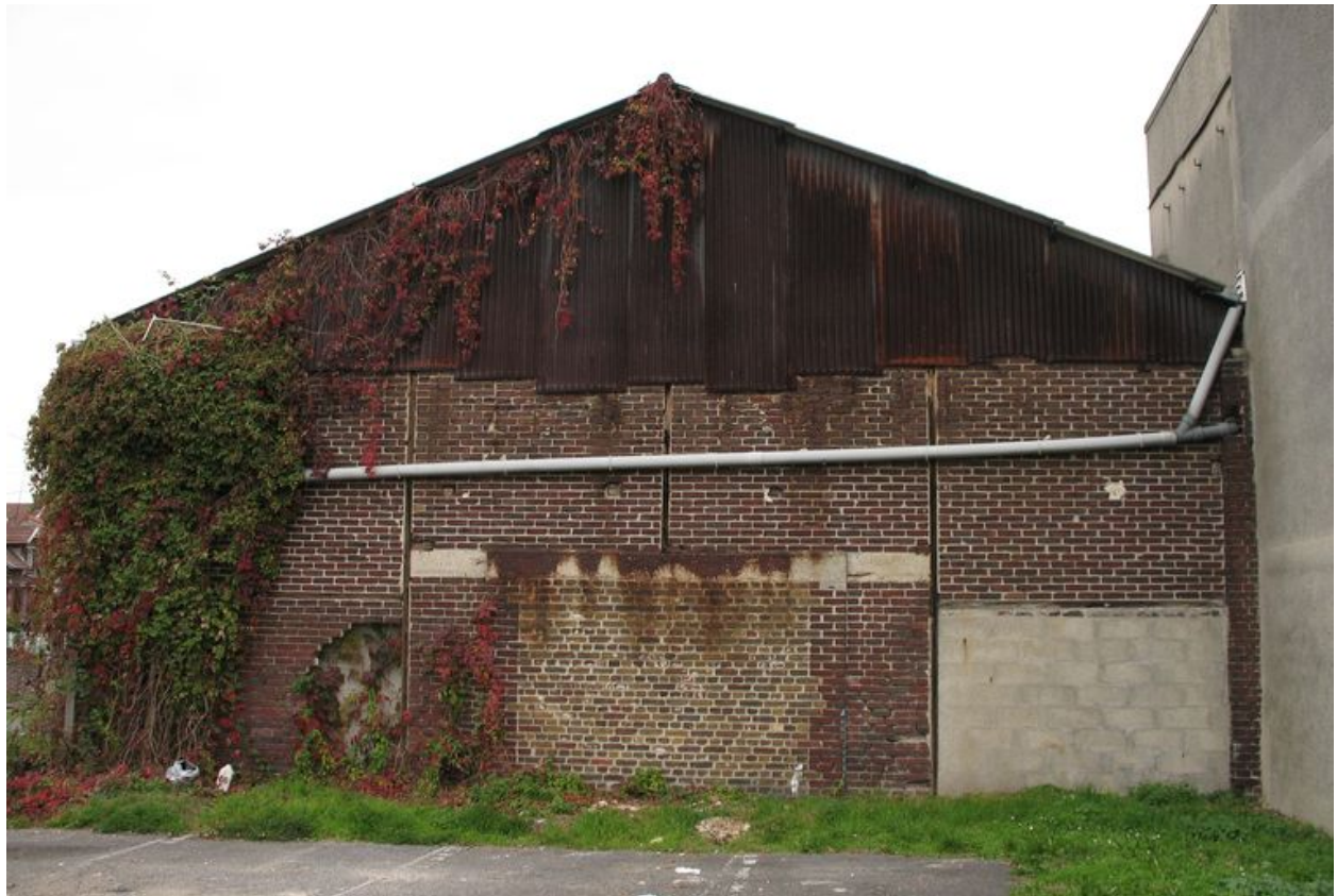
Etat du mur pignon sud-ouest en brique.
