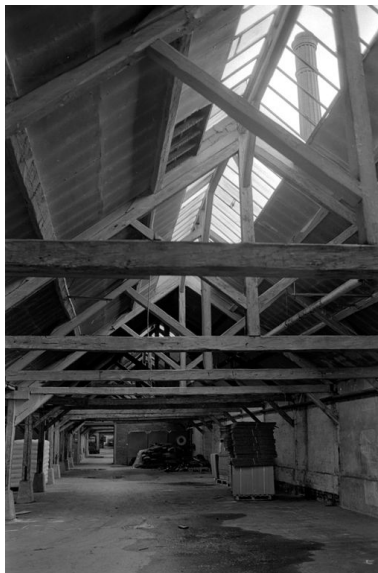
Câblerie, en 1983 : vue intérieure (Ecomusée du Beauvaisis). Phot. Thierry Lefébure, Autr. Francis Dubuc IVR22_20098000140NUCA
