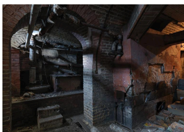
La chaudière située au sous-sol du château. Phot. Thierry Lefébure IVR22_20128000392NUC2AQ
