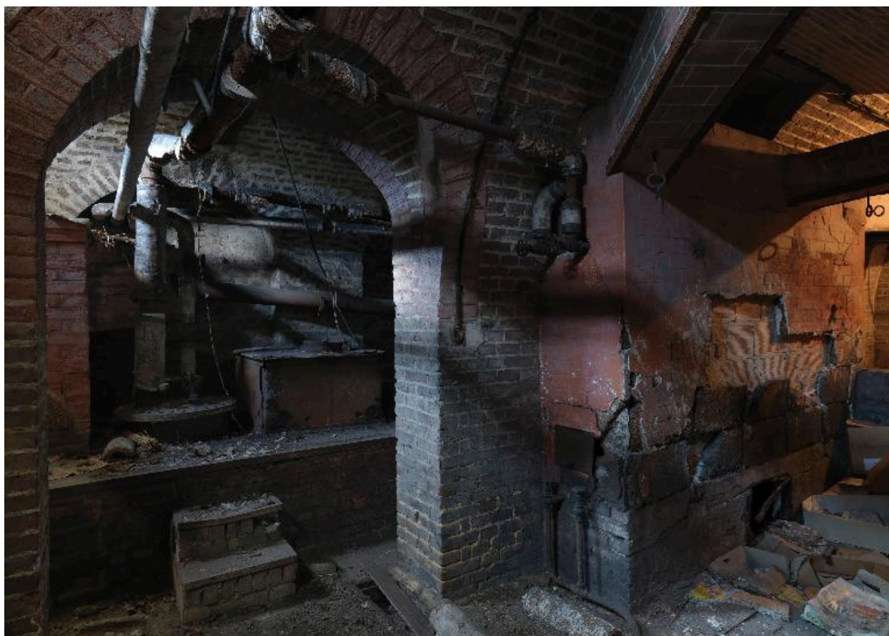
La chaudière située au sous-sol du château.
