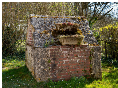
Puits dans la rue Behaize (en face du n°67), vue depuis le nord.
