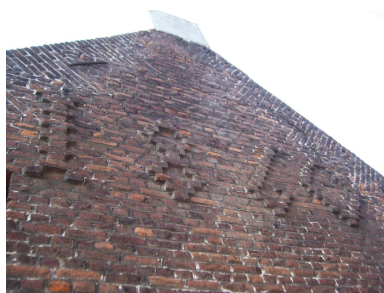
Détail du pignon nord, la date portée de 1860. Phot. Cyril Cailleau IVR31_20055907443NUCA
