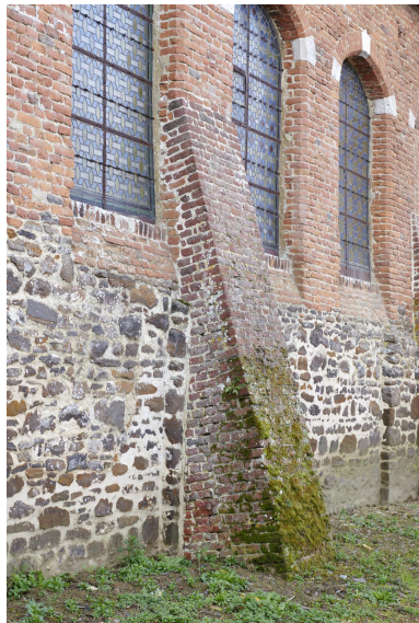
Détail de l'un des contreforts, renforcé aux périodes récentes (côté nord). Phot. Delphine Volto-Jourdan IVR32_20245901126NUCA
