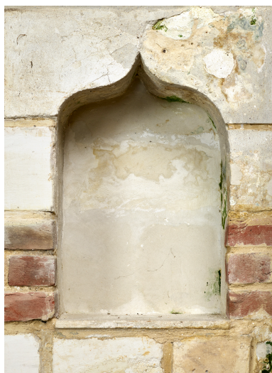
Intérieur, niche aménagée dans le mur nord de la nef. Phot. Thierry Lefébure IVR32_20258000077NUCA
