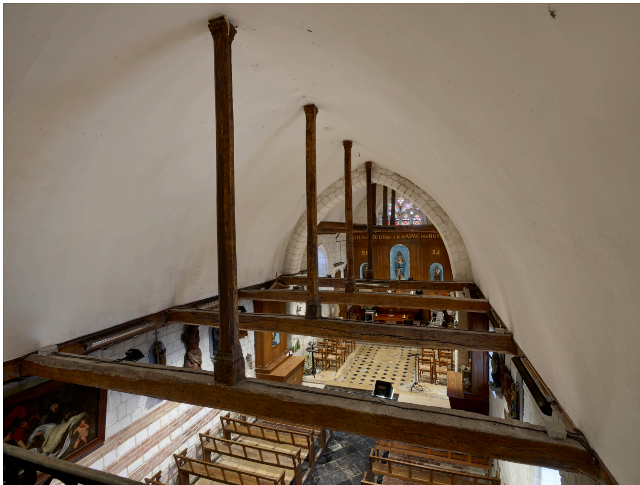
Intérieur, vue de la charpente et la fausse voûte depuis la tribune.
