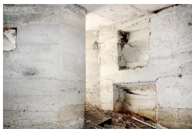
Entrée sud, le créneau de fusillade à gauche (au grand angulaire) Phot. Jean-Marc Ramette IVR31_20145905072NUCA
