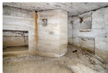
Salle sud avec, de gauche à droite, la niche centrale et l'entrée en chicane (au grand angulaire) Phot. Jean-Marc Ramette IVR31_20145905048NUCA
