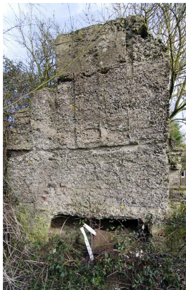
Vue latérale, vers l'est, de la tour d'observation Phot. Jean-Marc Ramette IVR32_20165901140NUCA
