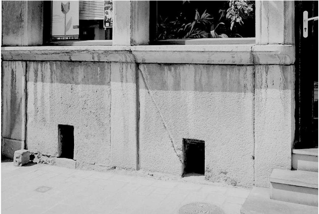
Façade, détail : soubassement et appuis de fenêtres du rez-de-chaussée ; on note l'emploi d'éléments monolithes et les traces d'outils.
