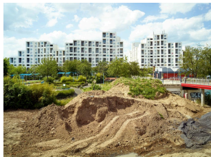
Quartier Le Pont-de-Bois : chantier à l'emplacement de l'ancien collège Léon-Blum, 2019. Au fond : l'îlot 4.
