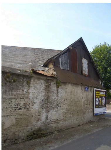
Pignon de la grange et mur de clôture. Phot. Inès Guérin IVR22_20078005226NUCA
