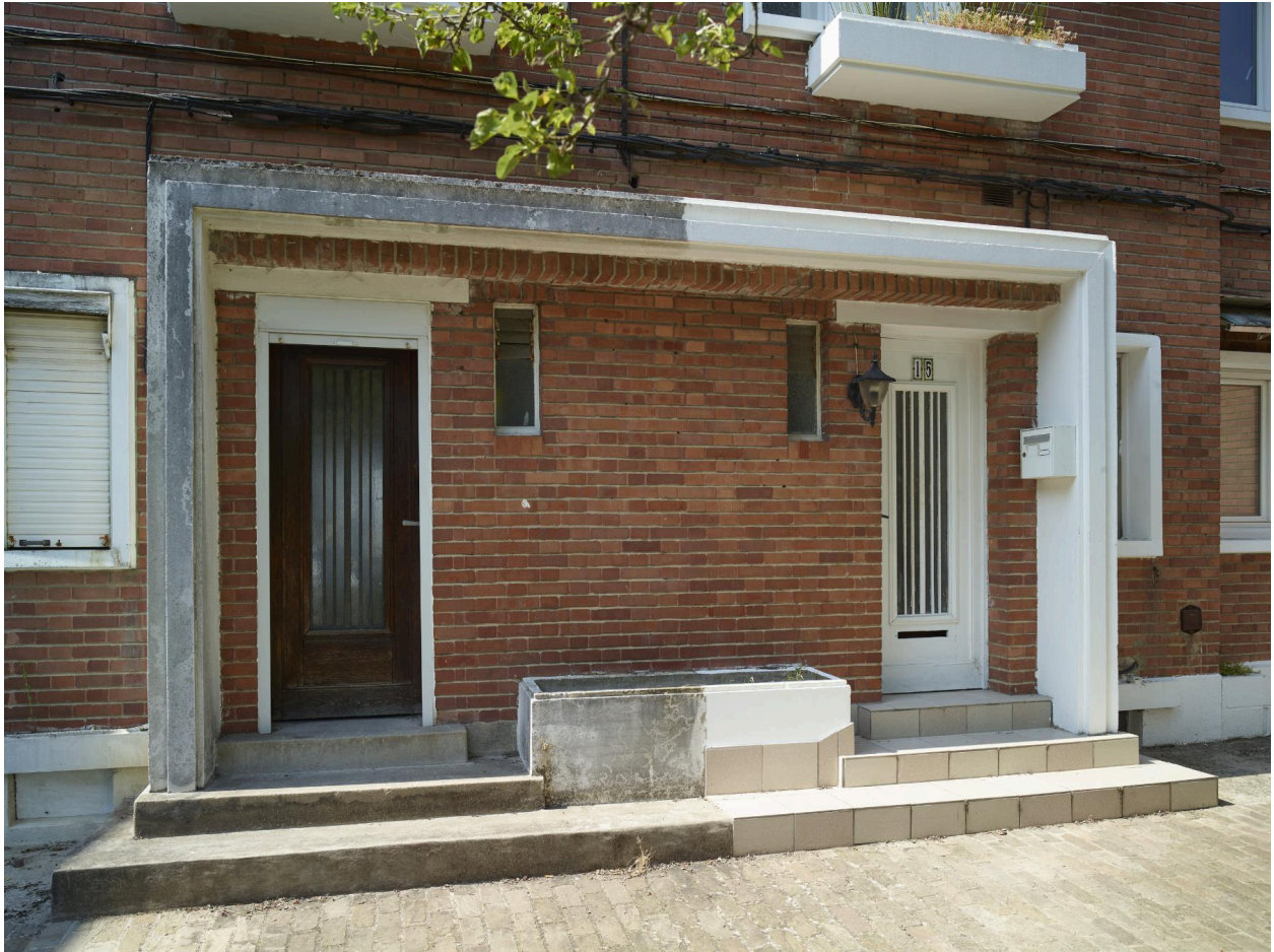
Détail de l'encadrement en béton des portes d'entrée côté place de l'Église (correspondant au n°15 rue Fournier).
