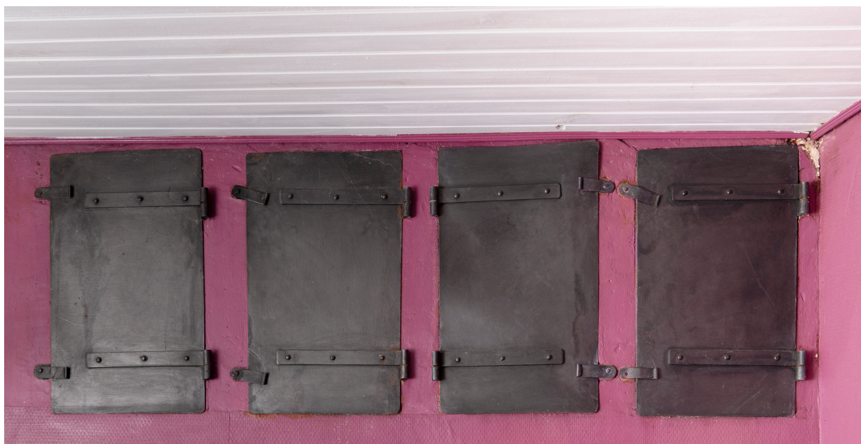
Portes d'accès aux conduits de chauffage, comble du n°3 de la rue de la Plaine.
