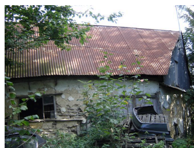
Vue du bâtiment au sud qui semble avoir été une étable depuis la cour. Phot. Inès Guérin IVR22_20078005315NUCA
