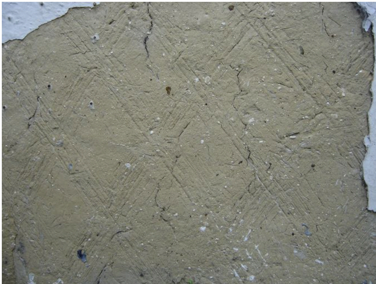
Détail du torchis et des sillons permettant une meilleure adhésion de l'enduit de finition.
