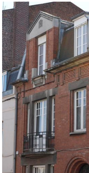
Vue sur la lucarne aux motifs et aux formes Art déco. Phot. Pierre Thibaut IVR31_20096200293NUCA
