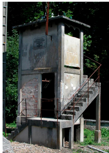
Vue du transformateur.
