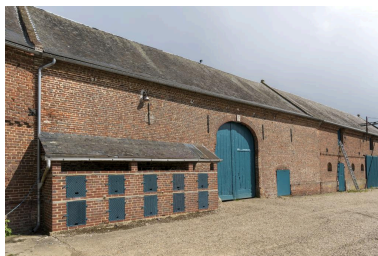
Grange et clapiers, 2e moitié 19e siècle, vue depuis le nord-ouest. Phot. Marc Kérignard IVR32_20216000432NUCA
