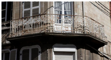
Ferronnerie Art déco du balcon situé à l'angle. Phot. Pierre Thibaut IVR31_20086200162NUCA
